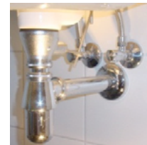
Eckventile unter dem Waschbecken mit Sifon
